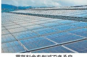
電気料金を削減できる自家消費型太陽光発電設備
