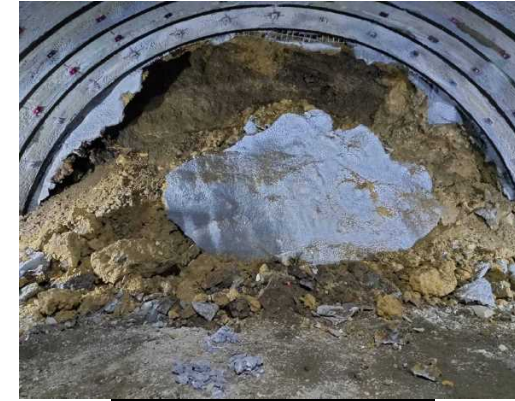
写真②:切羽崩落
