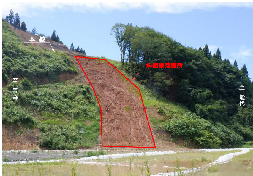
①斜面崩落状況（令和4年8月）
