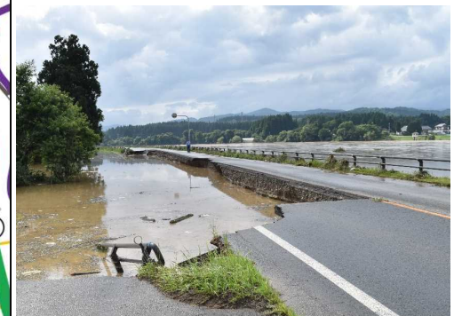
写真② 戸沢村蔵岡地区(道路崩壊状況)
