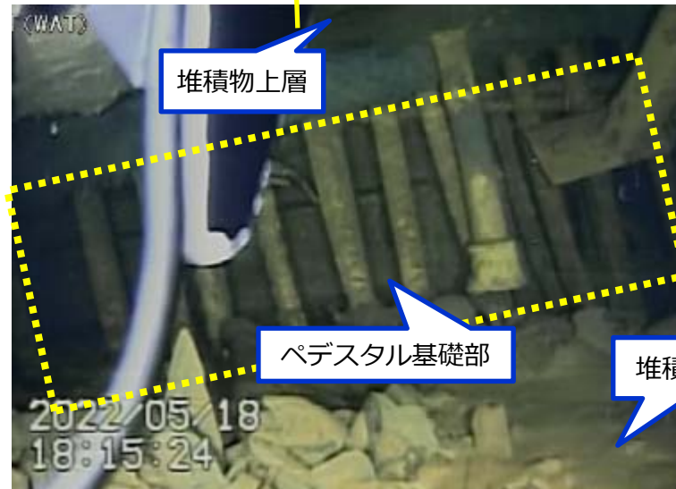
写真2.ペDESTAL基礎部付近の状況
