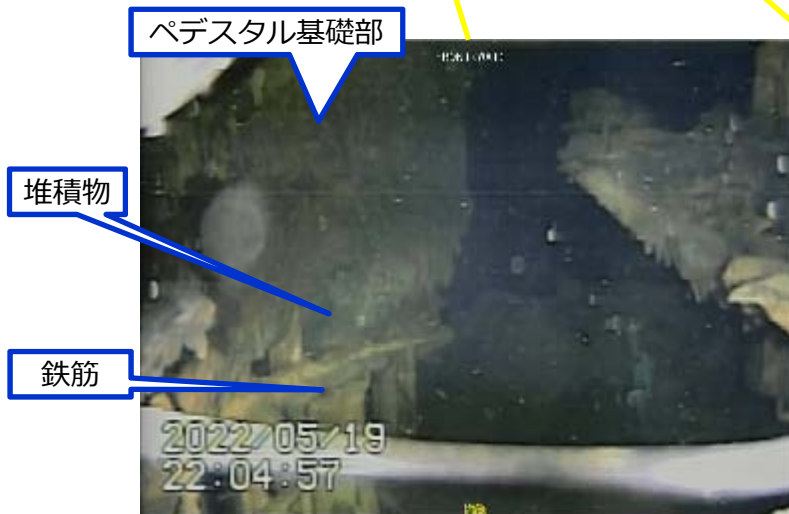
写真2.ペDESTAL開口部(左側基礎部)の堆積物を堺にした上下部の状況
