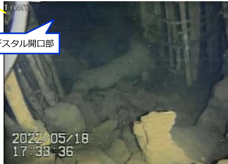
写真3.ペDESTAL開口部前の堆積物の状況
