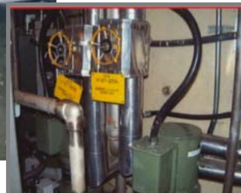
写真1.機器ドレンサンプポンプ付近の状況
