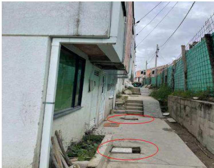
Imagen Nº 3. Foto capturada a través de visita de inspección realizada por esta Dirección, que obra en el consecutivo 19-131966-23.
