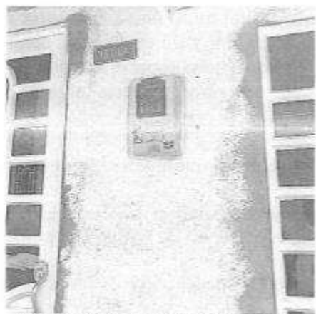
Contador de luz en funcionamiento.
