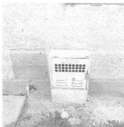
Contador del gas en funcionamiento.
