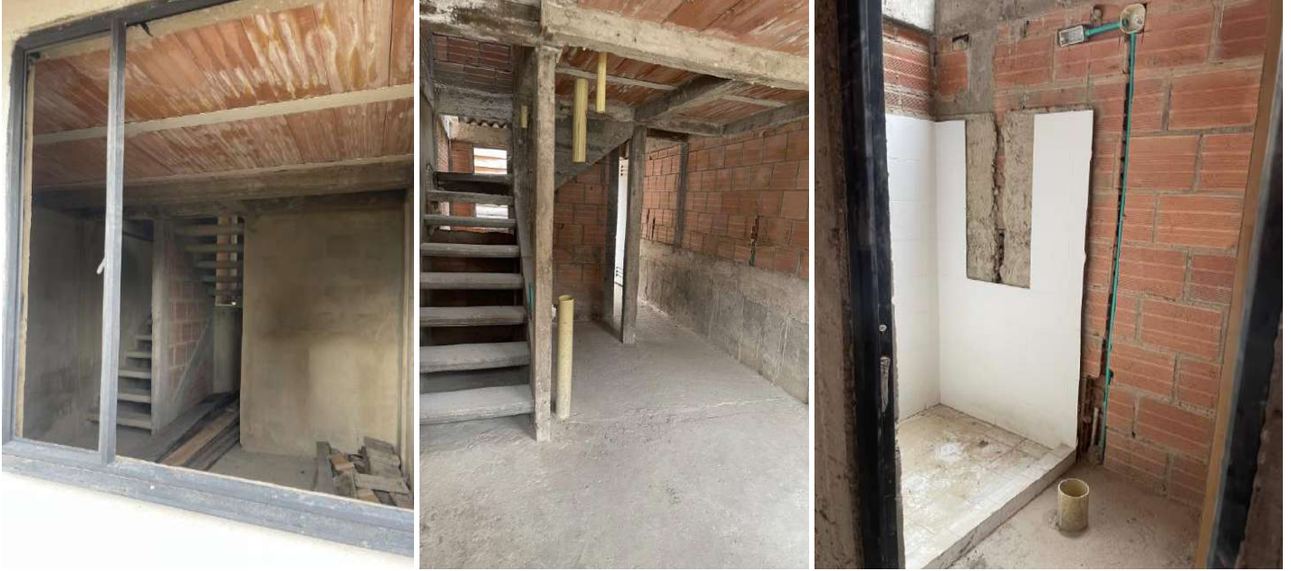
Imágenes N° 16. Fotos capturadas a través de visita de inspección realizada por esta Dirección el 16 de septiembre de 2021 al Proyecto Puerta del Rey de Usme -Bogotá, que obra en el consecutivo 19-131966-23.
