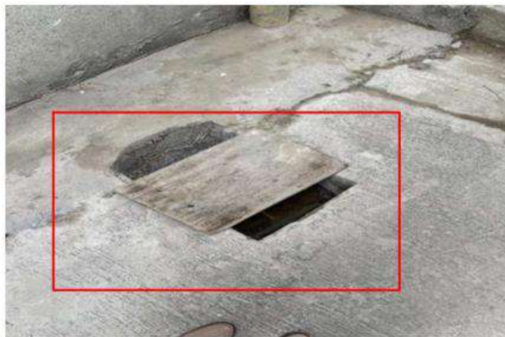
Imagen Nº 2. Foto capturada a través de visita de inspección realizada por esta Dirección, que obra en el consecutivo 19-131966-23.
