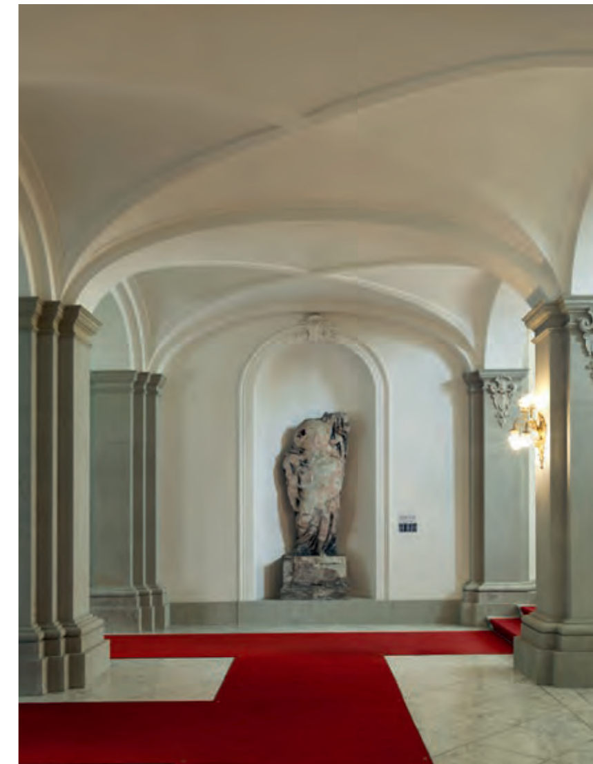
25 An der Justitia im Vorraum der Englischen Treppe lässt sich ablesen, wie sehr der Sandstein durch die hohen Temperaturen des Brandes zerstört wurde
