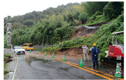
写真② 法面崩落の状況 (国道204号、松浦市御厨町、R5.9.15)
