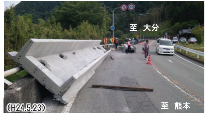
▲ コンクリート桁落下事故発生状況(写真②)
