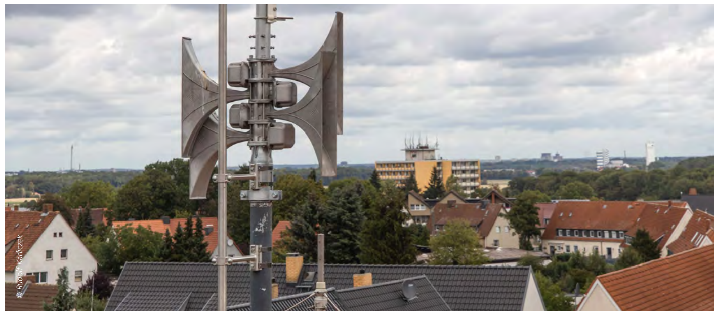
Neue Sirene auf dem Dach der Grundschule Steterburg in Salzgitter
