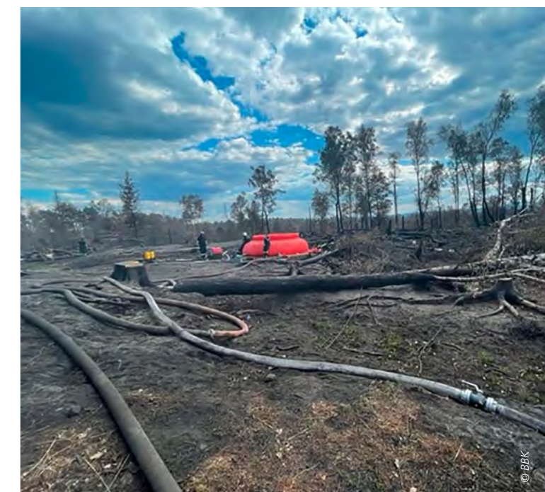
Für eine ausreichende und verlässliche Wasserversorgung wurden an verschiedenen Punkten im Gelände Faltbehälter als Pufferspeicher oder Übergabestelle für Löschwasser aufgebaut
