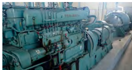
老朽化した干拓地のポンプ設備
