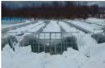
積雪により損壊したハウス (令和2年から3年までの冬期の大雪)
