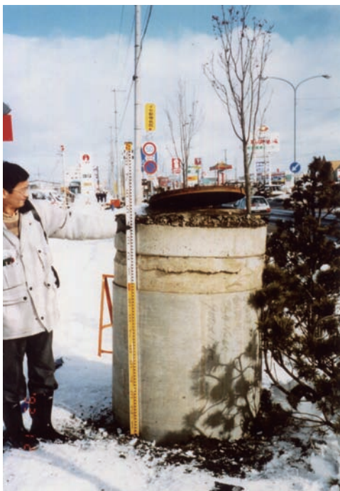
図3-14 「平成5年(1993年)釧路沖地震」の液状化現象によるマンホールの抜け上がり [基礎地盤コンサルタンツ(株)提供]
