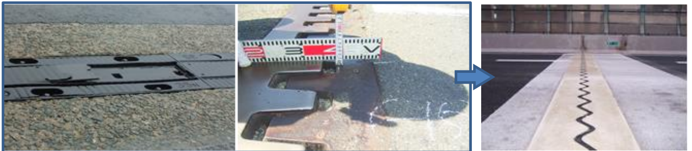
損傷事例(ゴムジョイントのはがれ)
