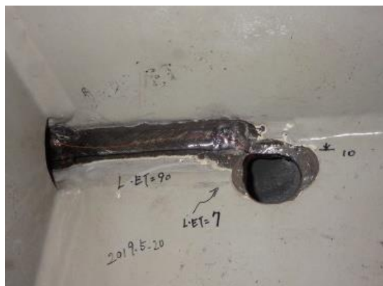
鋼床版の損傷状況
