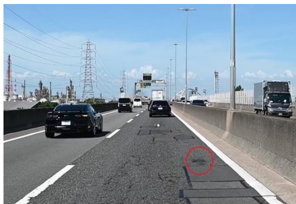
舗装の損傷状況
