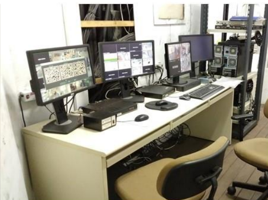
Foto - Sala de monitoramento Bloco "R" onde são alocados três postos (Brasília (DF), 5 de julho de 2018)
