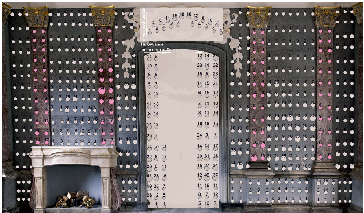
Abb. 1-11: Systematische Glanzmessungen auf den barockzeitlich polierten Kalksteinoberflächen im Marmorsaal des Alten Schlosses der Eremitage Bayreuth. Die niedrigen Werte verdeutlichen den weitgehenden Verlust der ursprünglich hochglänzend polierten Oberfläche. Rosafarbene Punkte: Kalkstein aus Horwagen, graue Punkte: Kalkstein vom Eichelberg bei Hof. Grafik: INKA PASSING.
