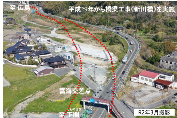
▲富海交差点付近の状況 (写真②)
