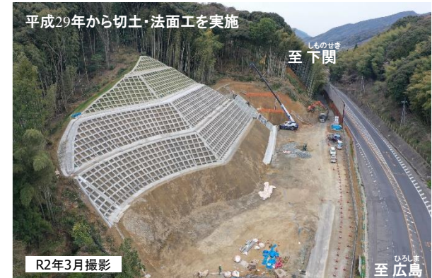
▲樺峠付近の状況 (写真③)
