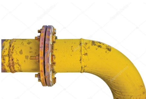
Figura 1.4a – Tubi fissati meccanicamente. [3]
