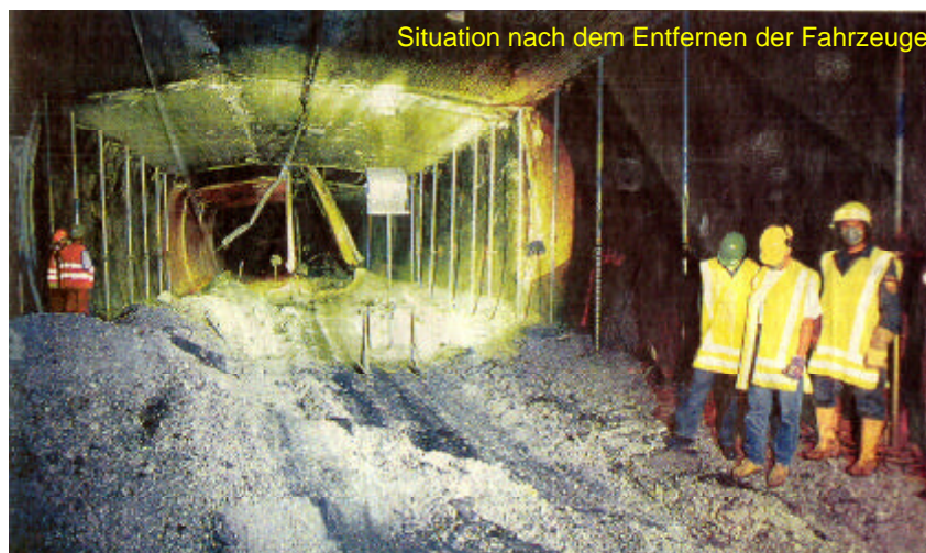
Bild 6: Brandstelle nach dem Löschen und Entfernen ausgebrannter Fahrzeuge
