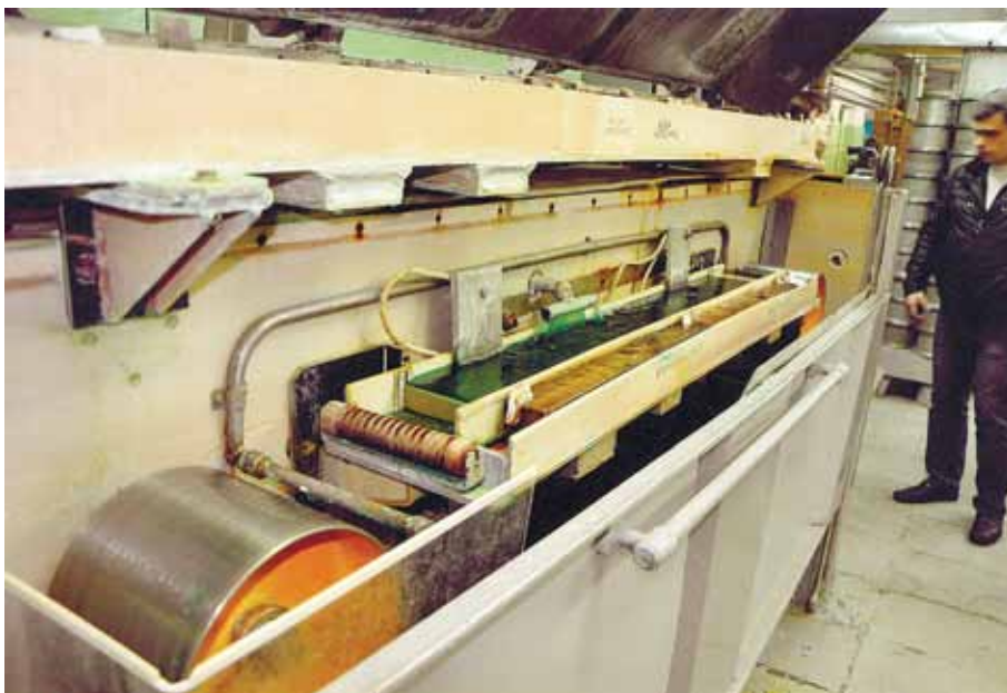
ЛГП – линия гальванического покрытия (никелем, оловом, серебром). Оборудование находится в эксплуатации завода «Микропровод» с 1977 года по настоящее время
