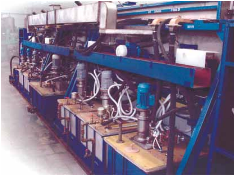
Современная установка СПКБ для нанесения гальванических покрытий
