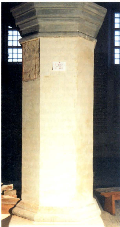
11. Filar pld.-wsch. od strony południowej, po zarzuceniu zaprawy wyrównawczej. Stan podczas konserwacji. South-eastern pillar from the south, after the use of levelling plaster. State during conservation.
