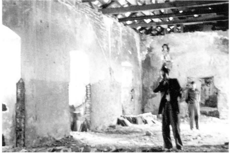
14. Tykocin, Alumnat wojskowy. Fragment wnętrza podczas prowadzonych na początku lat 50. XX w. prac konserwatorskich, Fot. W. Paszkowski 1953 r. [neg. WO SOZ Białystok, sygn. M/27/2349/4]. Tykocin. Veterans' home. Fragment of interior during conservation conducted at the beginning of the 1950s. Photo: W. Paszkowski 1953 (neg. WO SOZ Białystok, call no. M127/2349/4)
