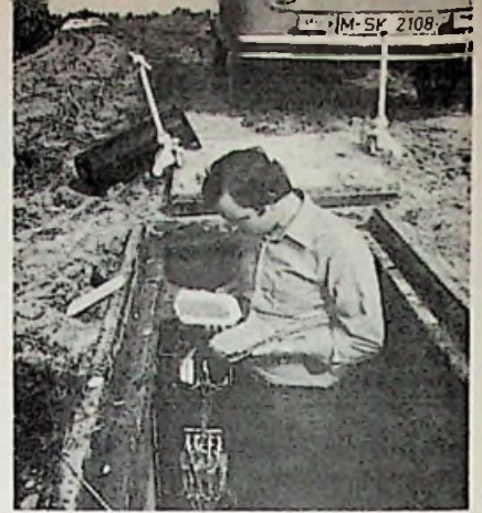
Twintig kilometer ten noorden van München werd in drie schachten een handvol elektronica ondergebracht, ter voorbereiding van een technische premiëre: het 12,7 km lange telefoontraject tussen Freising en Neufarn werd uitgerust met een nieuwe transmissietechniek, teneinde congestieproblemen op te kunnen vangen. Vooral voor verkeer over kortere afstanden kan zo aanzienlijk beter de bestaande capaciteit worden benut. Een speciale techniek, namelijk tijdmultiplexing, maakt op twee leidingen ruimte voor dertig gesprekken, die in meer dan twee miljoen impulsen per seconde worden „verknijpt”. Middels het nieuwe systeem „PCM 30” kunnen telefoonnetten zonder uitbreiding van de kabels qua capaciteit worden vergroot. (foto: Siemens)
