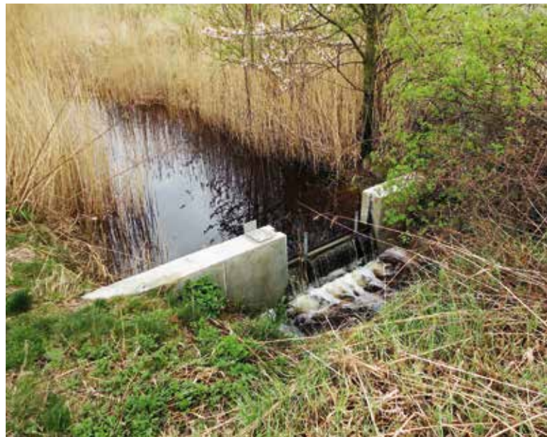
263/5: Halbherziger Rückstau des Scheibenlackenkanals – zur Sanierung der Lacke ist dieser Kanal komplett zu verfüllen! (6. März 2010)
