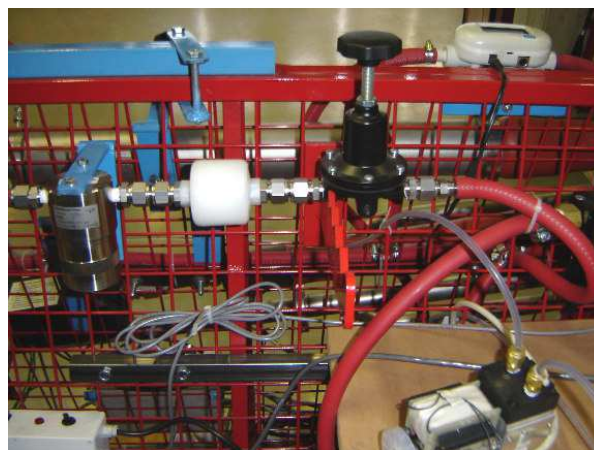
Régulation et conditionnement air dilution
