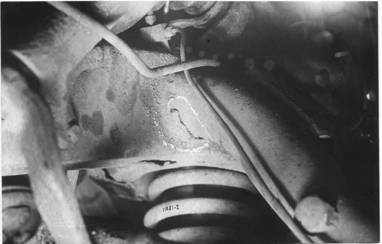
фото № 13. Трещины по сварке в месте соединения поперечины № 2 с лонжеронами рамы.
