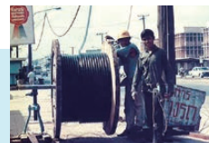
タイ・バンコク市内の通信網を整備
