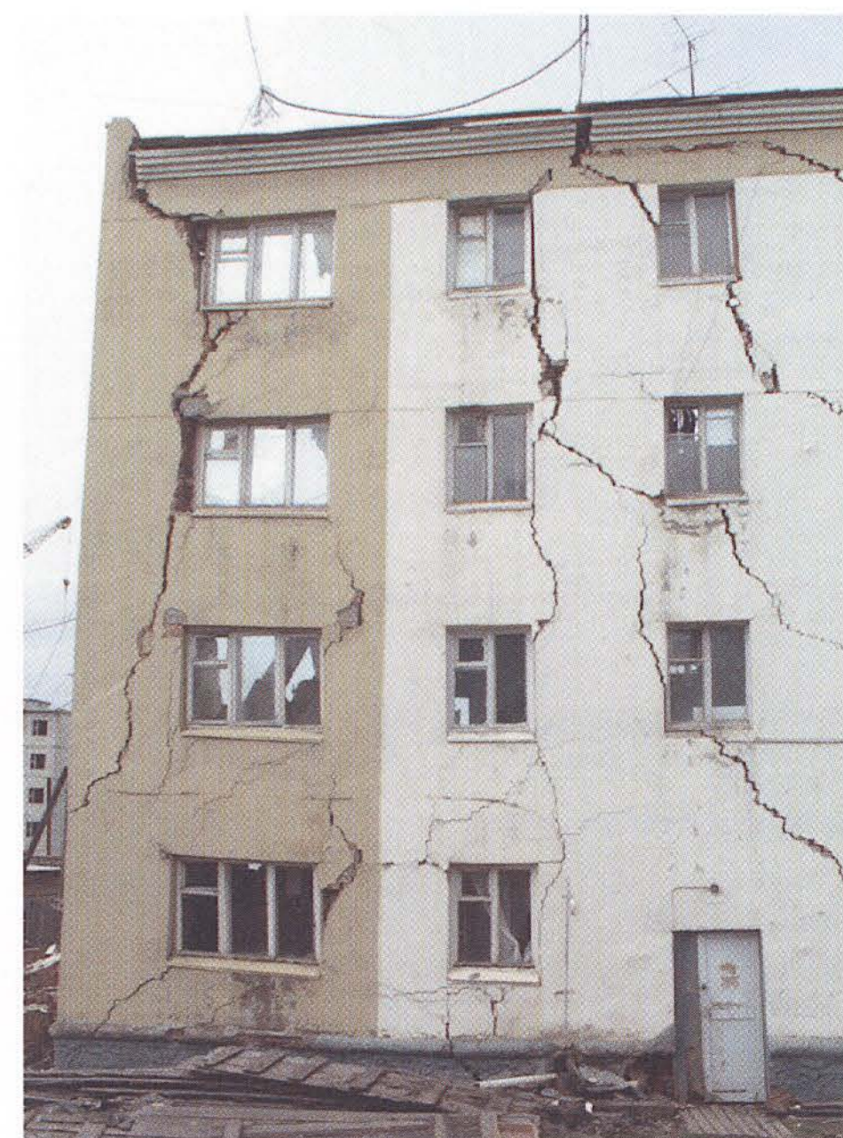
Gebäudeschäden aufgrund tauenden Permafrosts in Tscherski, nahe der Mündung der Kolyma, Russland
