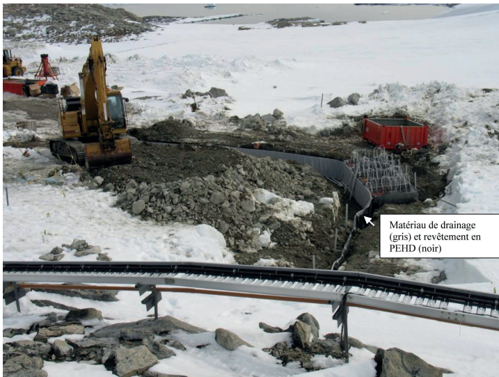
Photo 2 : Installation des ailettes et de la porte. Remarque : la porte est équipée de nombreux instruments à des fins de recherche.
