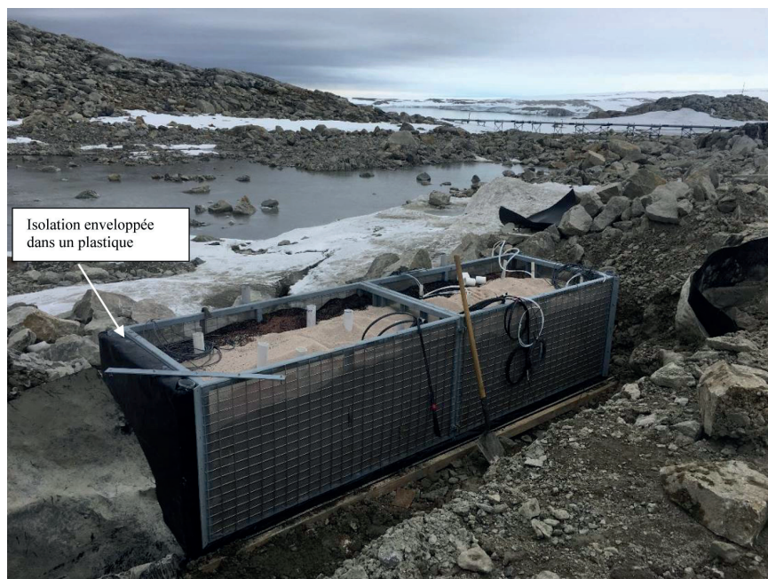
Photo 4 : Porte de BPR en construction avec une « cage palette », et piézomètres (tubes blancs) pour la surveillance de l'eau et des substances réactives granulaires structurées. Le fil noir est un câble chauffant à relier.
