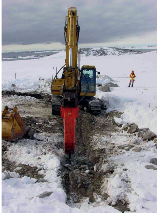
Photo 1 : Creusement d'une tranchée pour une ailette de BPR dans un sol gelé.
