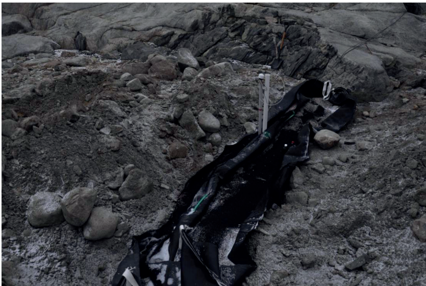
Photo 6 : Porte de BPR installée à l'aide d'un tube géotextile (tissu noir). Remarque : une fois en service, les couvertures supérieures sont fermées pour éviter que les substances granulaires ne se dispersent dans l'environnement.
