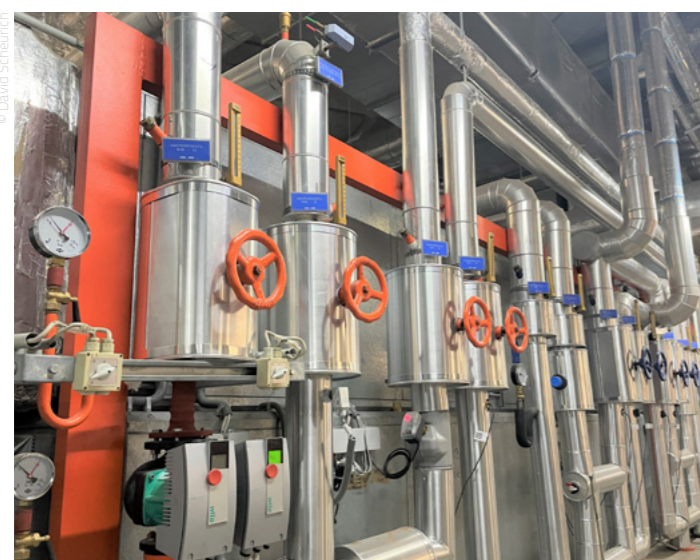
Einblick in die Klimazentrale des Austria Center Vienna.
