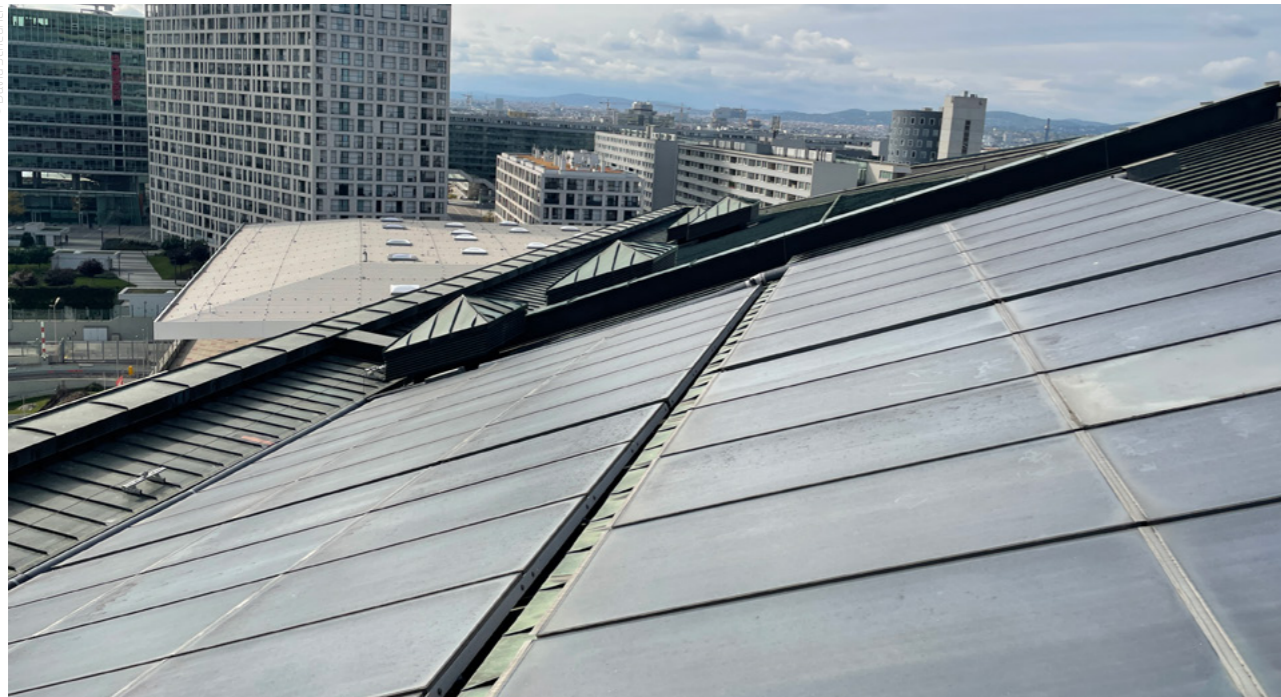
Die thermische Solaranlage auf dem Dach versorgt das Haus mit Warmwasser.
