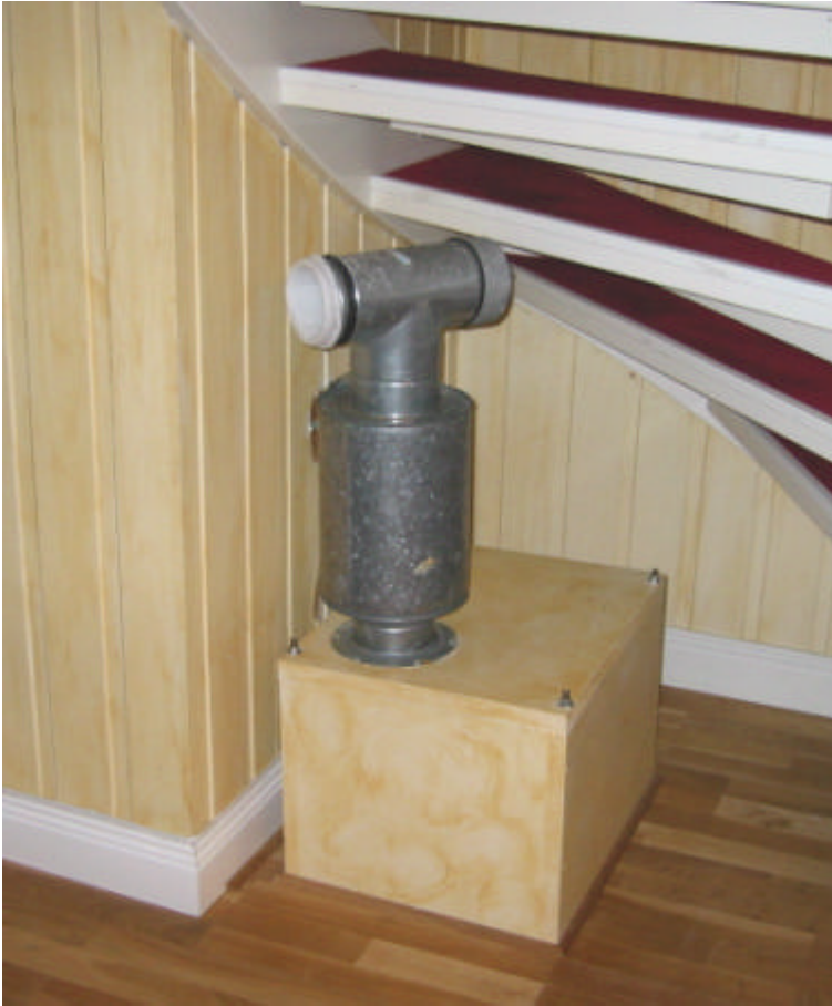
Figur B1.4 Anläggning för att skapa en luftkudde under huset har här placerats under trappan ner till gillestugan i suterrängplanet. På bilden syns luftintagsröret, som också innehåller ett dammfilter, samt en ljuddämpare. Fläkten är placerad i lådan under ljuddämparen.
