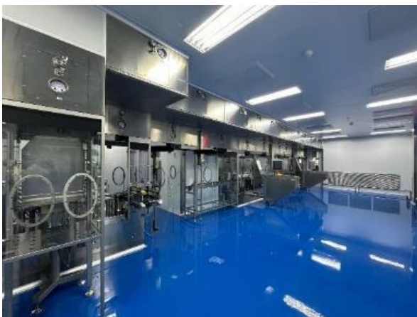
B07 – Linha de envase instalada e em testes.
