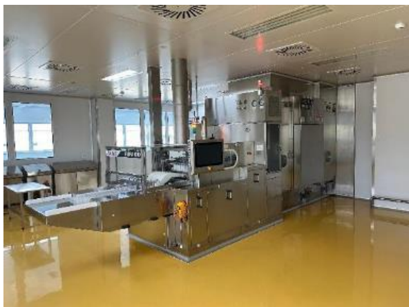
B07 – Linha de envase instalada e em testes.
