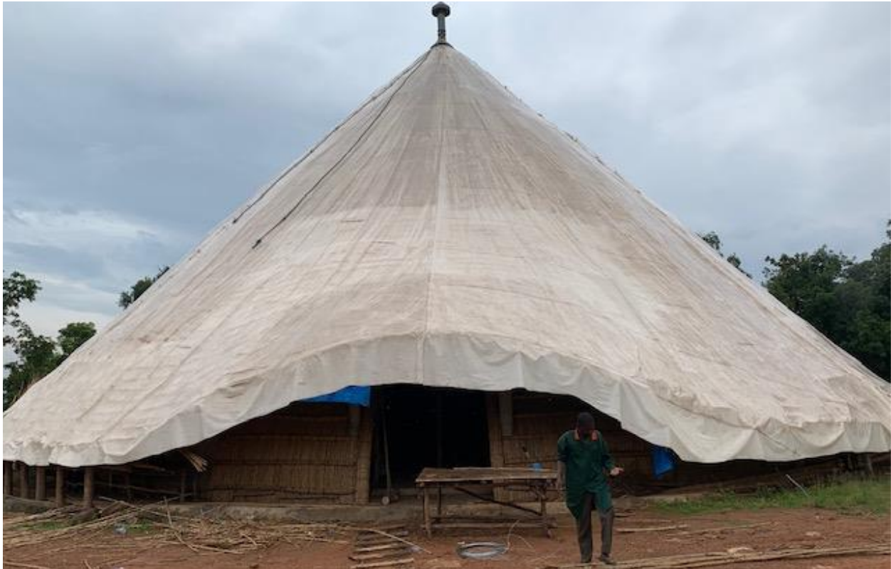
Chantier de reconstruction des tombes des rois du Buganda a Kasubi en Ouganda ©FPMA
