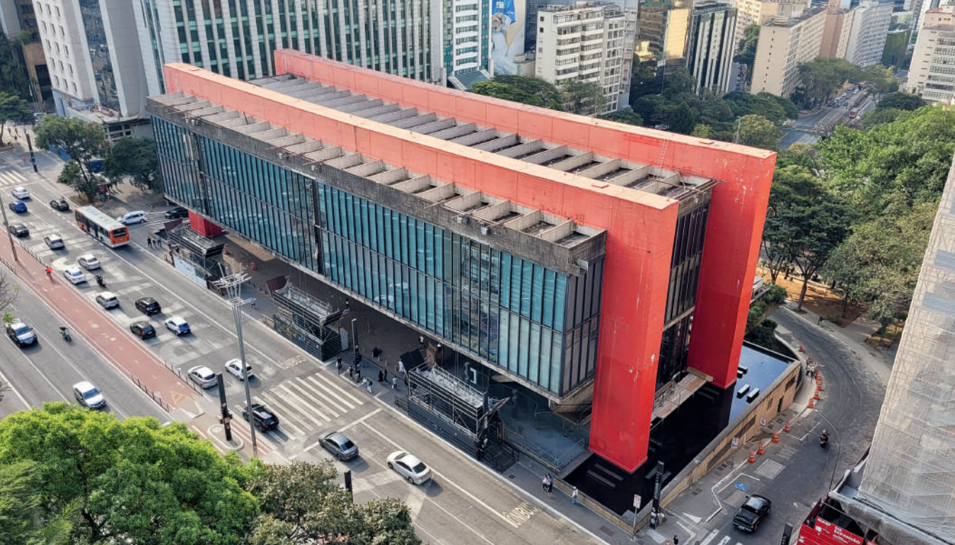
Vista lateral da fachada do MASP voltada para a Avenida Paulista com andaimes durante a reforma da caixilharia
