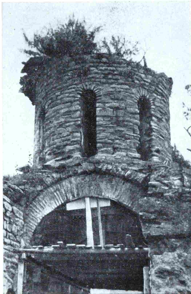
Рис. 4. Барабан с восточной стороны. Видна обнажившаяся подпружная арка и остатки коробового свода
