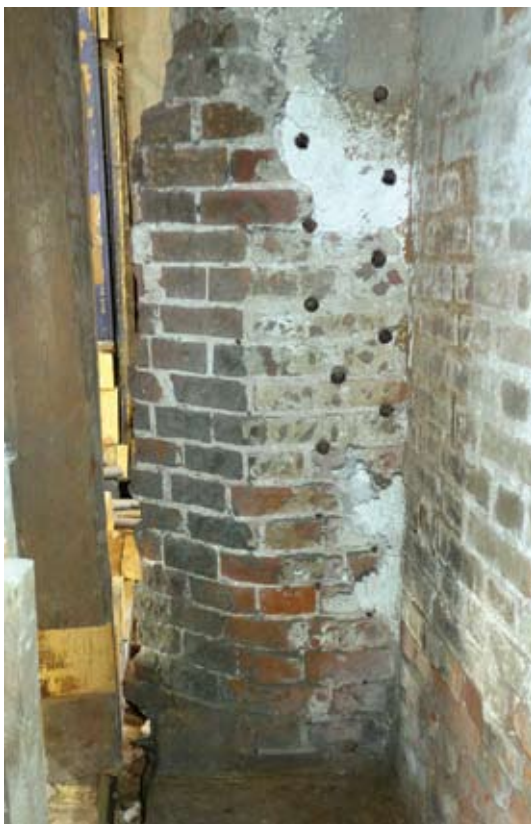
Ил. 7. Южная грань пилона, выступающего из центральной алтарной преграды. Видны участки залевкашенной поверхности и фресковые гвозди. Фото 2018 г.
