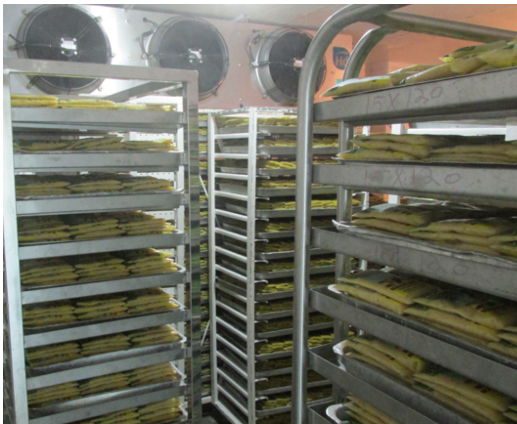
Figura 9. Túnel de congelamento rápido.
