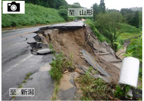
▲飯豊町手ノ子地内の盛土崩壊状況 (R4.8.4)
