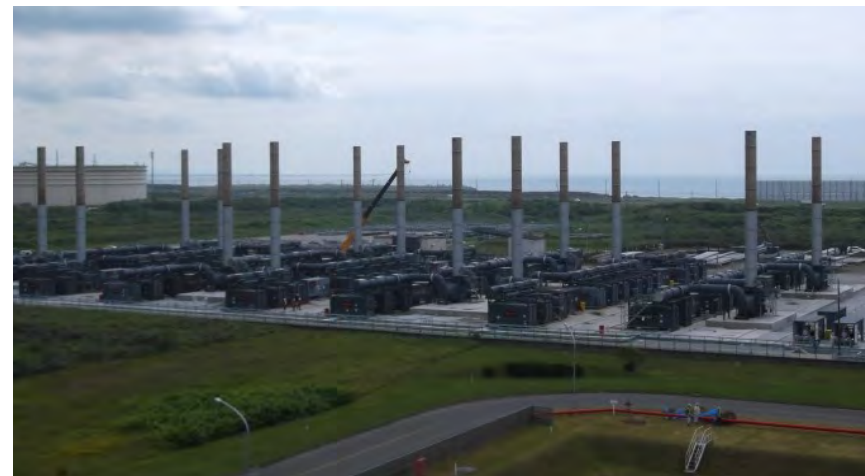
【写真】 苫小牧発電所に設置した緊急設置電源
