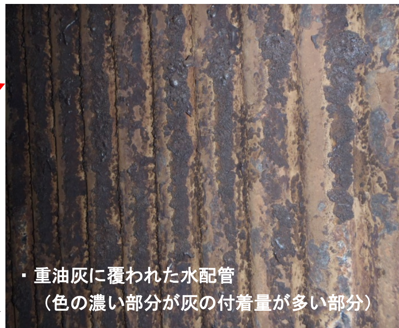
ボイラー内部水配管表面
