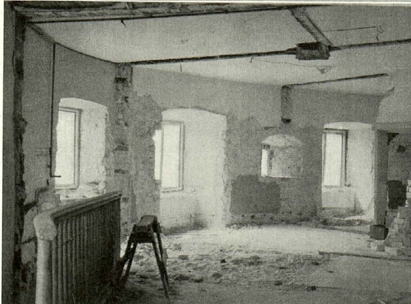
Pågående rivning av övre våningens bostadsinredning. — Å nedre bilden syns framtagna skottglugg.
