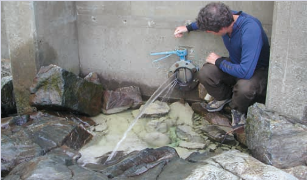
Selv om konsesjonsvilkåret angir at det skal slippes en minstevannføring, er det viktig at myndighetene kontrollerer at dette blir gjort. Her var ventilen skrudd igjen. Foto: Jon Arne Eie.
