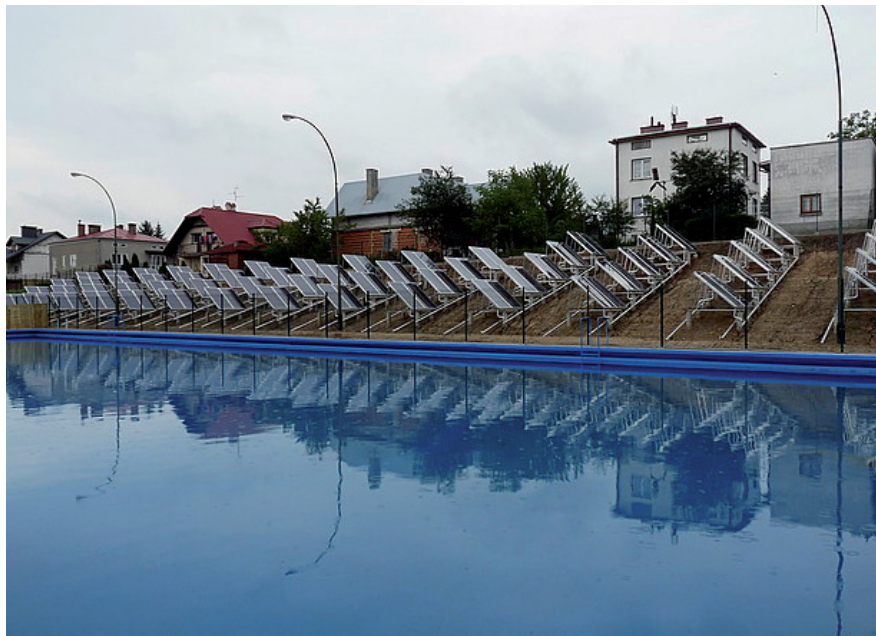
Baseny kąpielowe w Boguchwale podgrzewane kolektorami słonecznymi (fot. www.boguchwala.pl )
