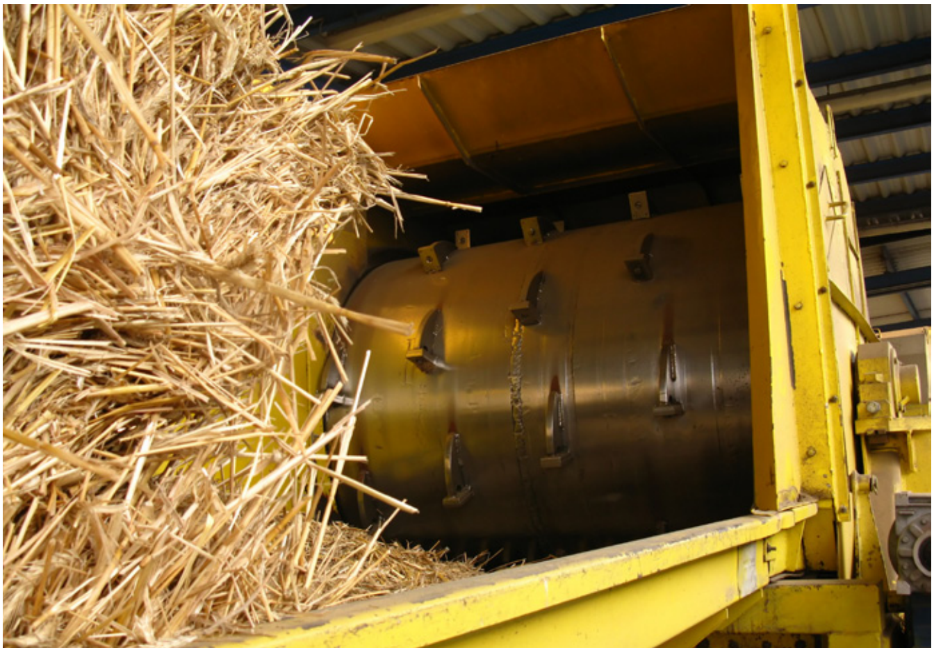
Elektrociepłownia opalana biomasą
