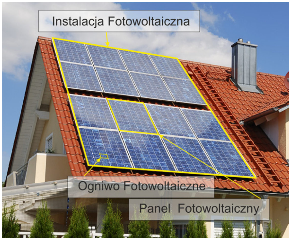
Instalacja fotowoltaiczna zainstalowana na dachu
