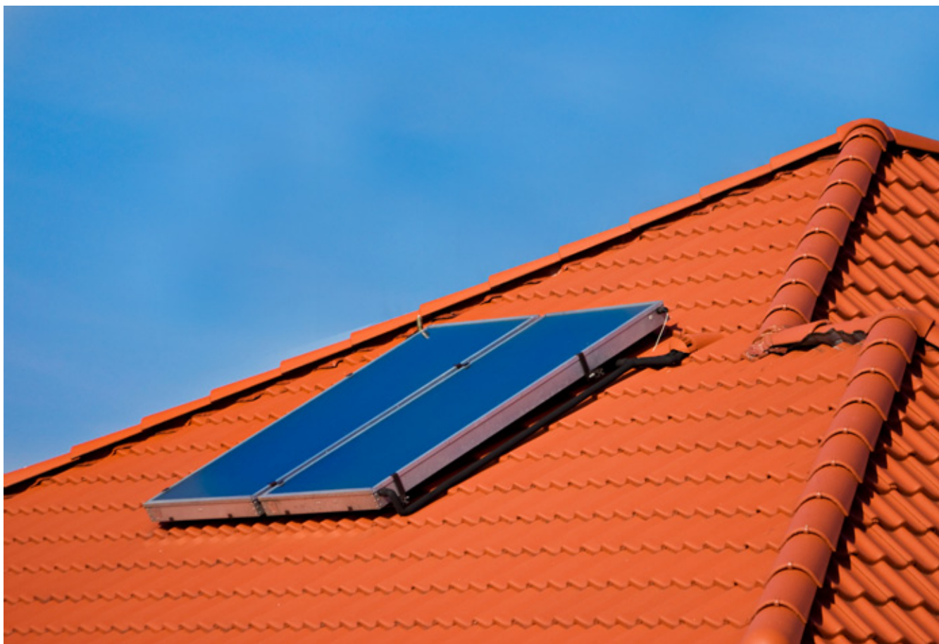
Kolektory płaskie zainstalowane na dachu
