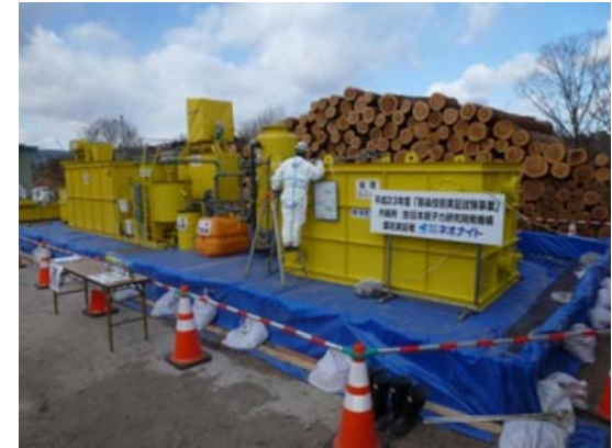
除染設備全体
