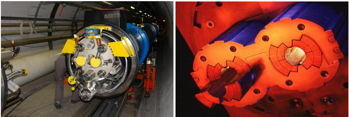
Рисунок 1-2 Установка криомагнитов в туннель LHC (слева), сверхпроводящий дипольный магнит (справа)
