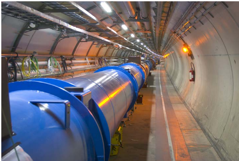
Figure 1 : Vue du tunnel LHC
