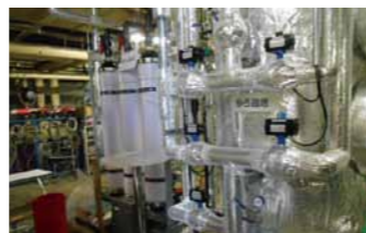
地下水膜ろ過システム
