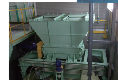
◀バイオガスプラントの食品残渣を粉砕する装置
