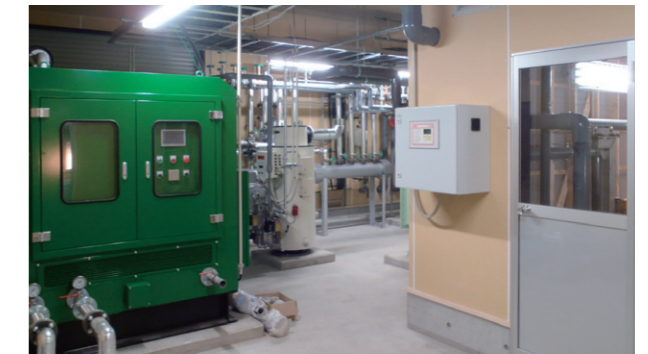
▲バイオガスプラントの機械室
