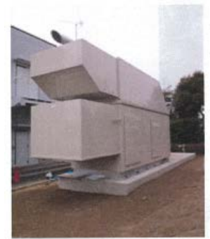
震災後導入した発電機
