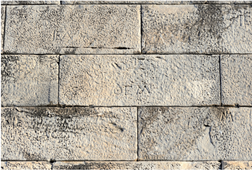
2 Ausschnitt der südlichen Sekoswand des Apollontempels in Didyma mit Steinmarken in situ | Section of the southern sekos wall of the Temple of Apollo at Didyma with stone marks in situ (© ÖAW-ÖAI, H. Lotz)
