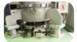
真空タンクの足回りにも多くの防振機構が組み込まれている（写真は南端のタンクのもの）。
