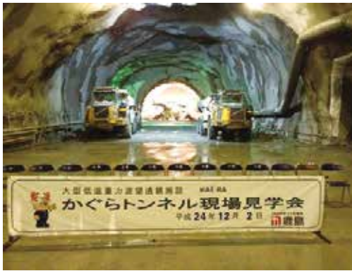
図02 KAGRAが建設されるトンネル内の様子です(くわしくは24ページへ)。
