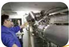
真空パイプ内の区分分離用のゲート機構。
