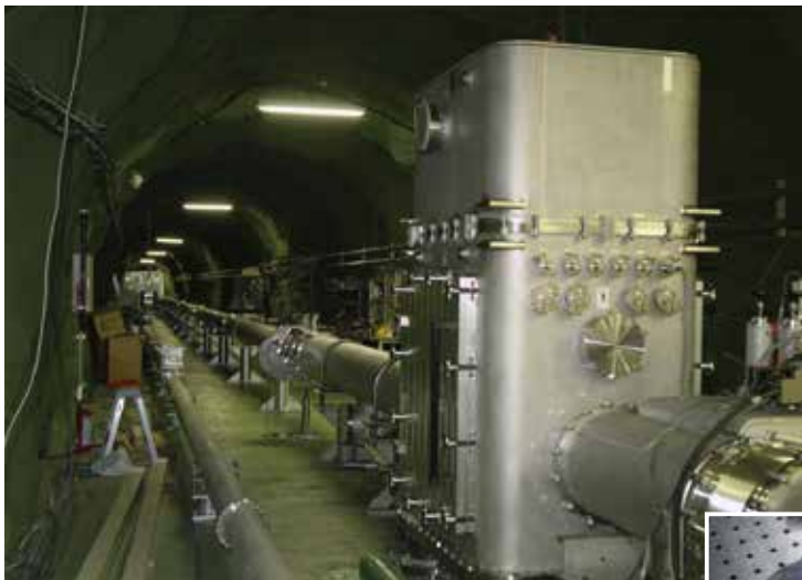
04 地下1000mの地下トンネルに設置されたCLIOの真空タンクと真空パイプ（直径30cm）。地下深くに設置して地面振動を減らす方式は日本独自のものです。
