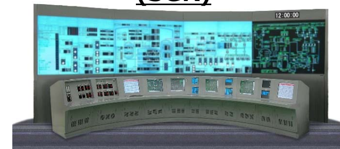
【中央制御盤取替工事】(CBR) 最新デジタル制御技術の適用
